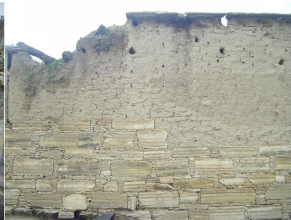
Πέτρινη τοιχοποιία στη βάση της οικοδομής (τοπικά ιζηματογενή πετρώματα) και από πάνω πλιθάρια
